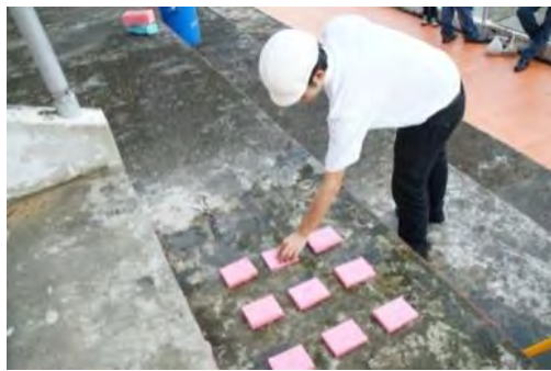
รูปที่ 15 การใช้พองน้ำที่ชุ่มด้วยสารละลายคอปเปอร์ซัลเฟตวางบนผิวคอนกรีต
